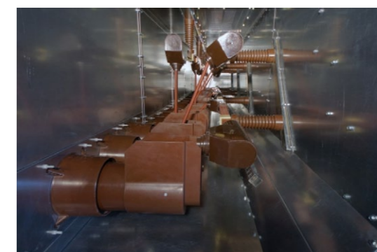
Отсек главных шин
