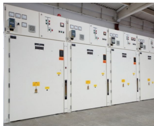
Ряд шкафов SMU-35
